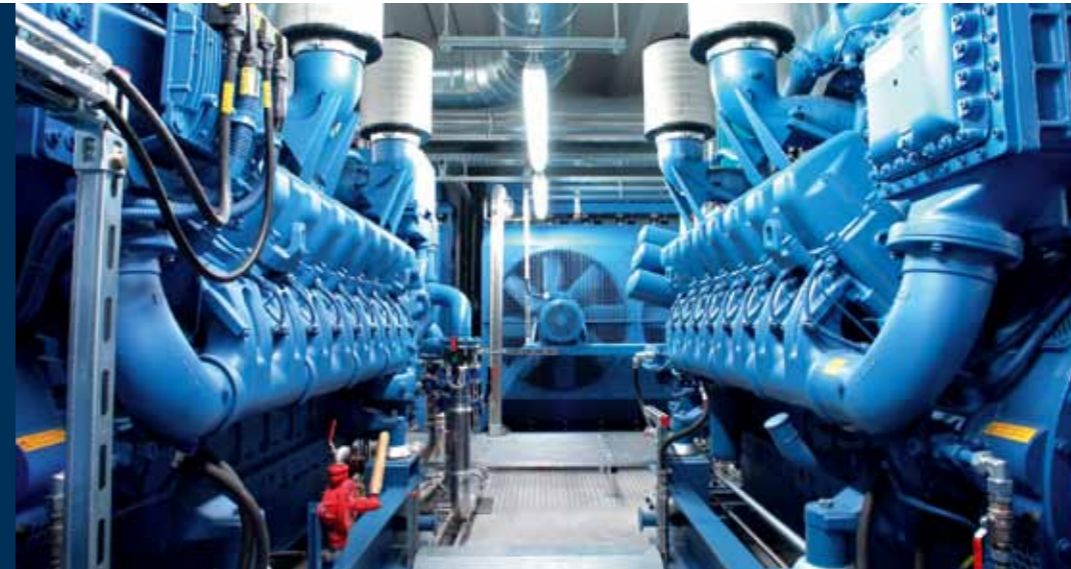
Leistungsstark: parallel geschaltete Notstromaggregate im Einsatz
