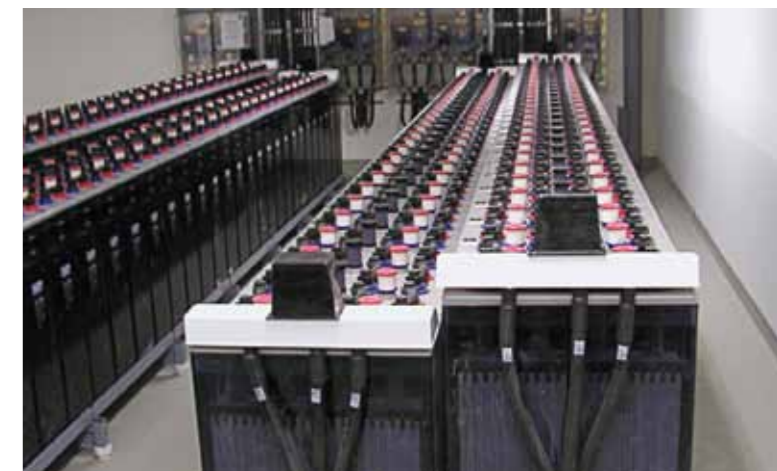
Batteriebanken liefern gespeicherte Energie für den unterbrechungsfreien Betrieb Ihres Unternehmens.
